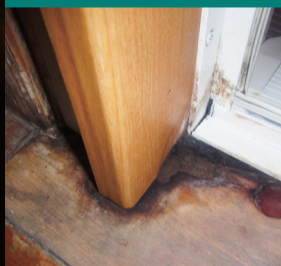
浴室・台所の水漏れ
