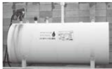
西奈良支所バイオディーゼル燃料タンク
